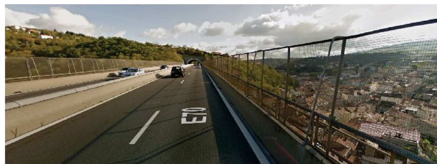
Figure 8 : Exemple d'« écran de retenue d'objet » sur le viaduc de l'A57 à Rive-de-Gier - Source : image street-view
