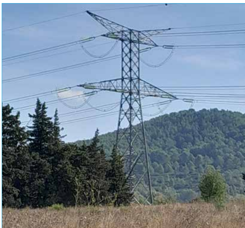
Exemple d'une ligne aérienne construite avec des pylônes de type F44
