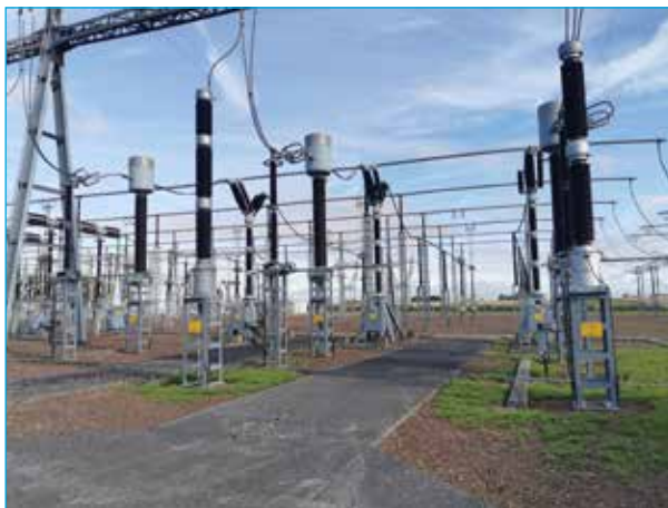
Exemple de cellules-lignes dans un poste 400 000 volts
