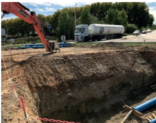
Création d'une plateforme DECI dédiée à l'intervention des pompiers (Parc d'activités de Saint-Martin-de-Crau)
